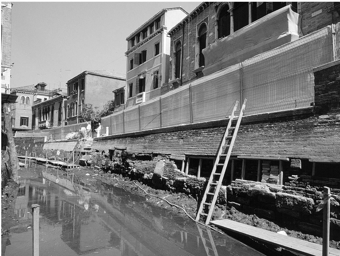
Rio de la Frescada, prima del risanamento
