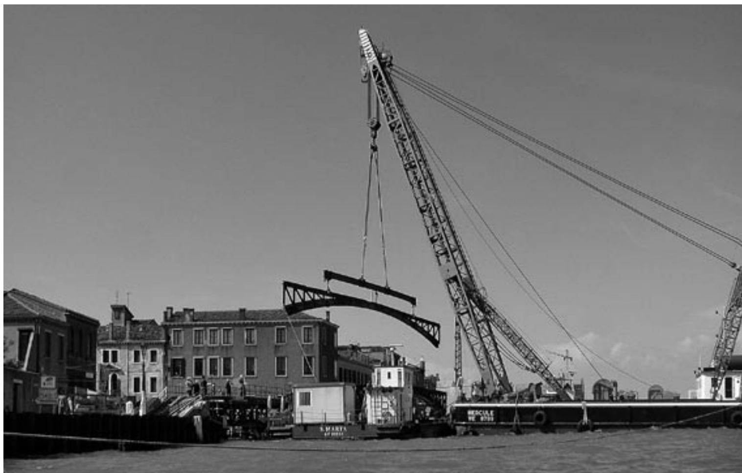
Sollevamento delle tre arcate effettuato dal pontone Hercule (622 tonnellate di stazza, munito di gru fissa da 130 tonnellate) e loro posizionamento sul pontone motorizzato Santa Marta (120 tonnellate di portata).
