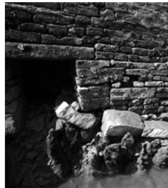
Collasso di un muro di fondazione in prossimità di uno sbocco di acqua mista.
