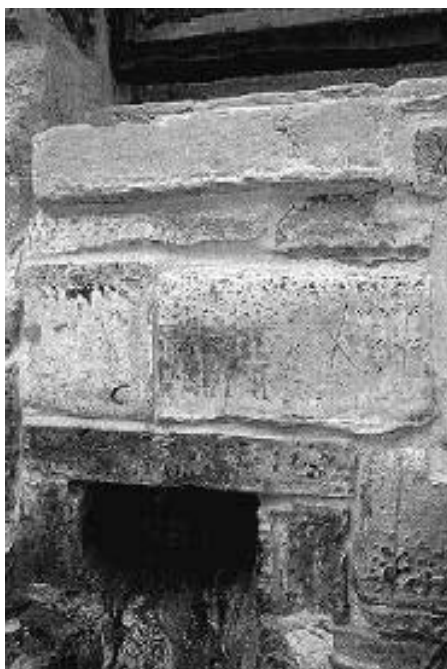
Uno scarico fognario in Rio di San Severo, settembre 1999
