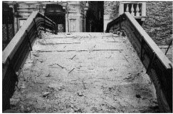
Ponte del Traghetto (o Centani): consolidamento dell'arco in muratura mediante ricuciture murarie ed iniezioni mediante leganti colloidali; parapetti eseguiti mediante canale in acciaio inox, nuova sede dei sottoservizi rimossi dall'arco del ponte per consentirne il recupero strutturale
