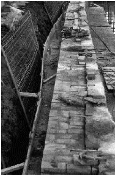
Rio Marin, Fondamenta Gradenigo: chiavi e collegamenti mediante "arpesi" in acciaio inox del rivestimento in pietra al corpo di sponda in muratura
