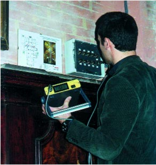
Fig. 9 - Sistema di monitoraggio a lettura manuale installato nella chiesa dei Santi Giovanni e Paolo: apparecchiatura elettrica di tipo rimovibile per il rilievo periodico delle misure
