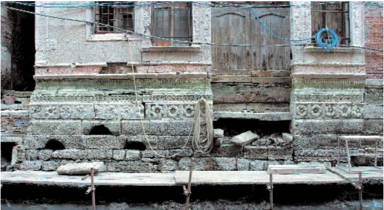
Il degrado di un edificio in rio della Fava, settembre 2002
