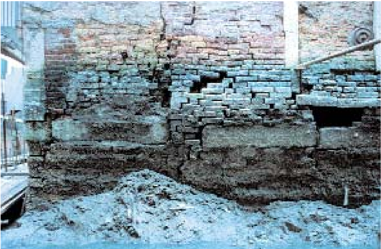
Degrado e dissesto di un muro di sponda in rio di San Zaninovo, dicembre 1998
